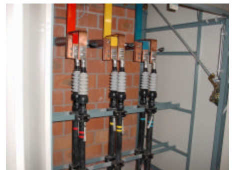
Instalación en interior
