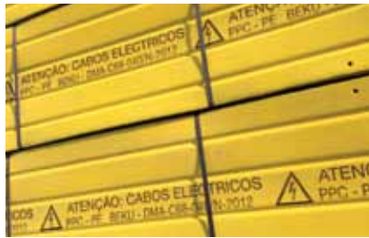
Placas para protecção de cabos enterrados.
